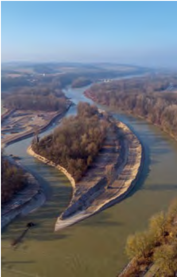
Baustelle bei Landau. Der Hochwasserabfluss in der Isar hat zur vorzeitigen Flutung des neuen Nebenarms geführt.
