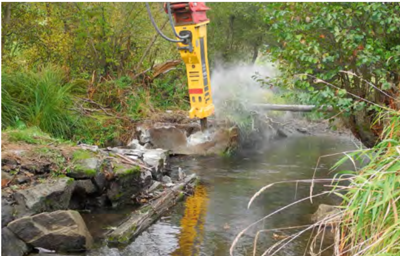
Rückbau eines Querbauwerks an der Mitternacher Ohe (Niederbayern) durch den LFV Bayern.
