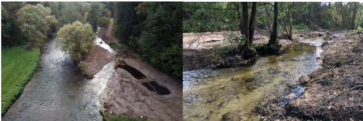
Abbildung 81: Beispiel für eine Renaturierungsmaßnahme in einem Gewässer ähnlichen Typs an der Großen Mühl bei Ulrichsberg (Wiederherstellung eines ehemaligen Nebenarms). Aufnahme bei Niederwasser unmittelbar nach der Baumsetzung. Neben strukturreichen lotischen Habitaten wurden auch einseitig angebundene Arme und Buchten umgesetzt. Foto W. Lauber, ezb-TB Zauner.
