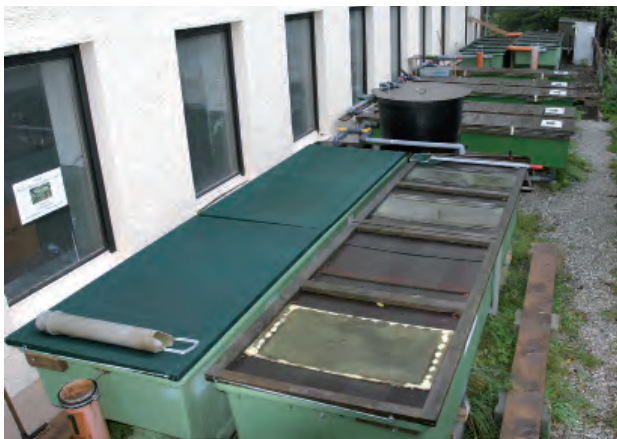
Abb. 2: Langstromrinnen auf dem Gelände der AÜW/Kempton
