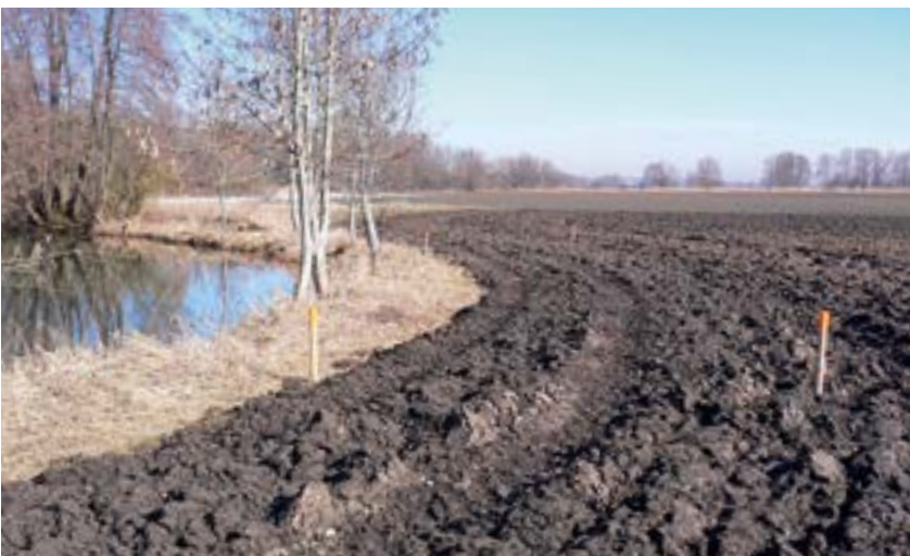
Bevor die Bagger an das Vilsaltwasser gelangen, muss ein Wirtschaftsweg, den der Landwirt „freiwillig“ als Acker nutzte, wieder hergestellt werden.
